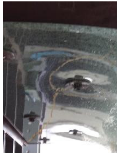
그림 12. 응력집중현상에 의한 볼트접합부 파괴
