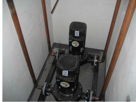
(b) 존 냉·난방용 순환 펌프
