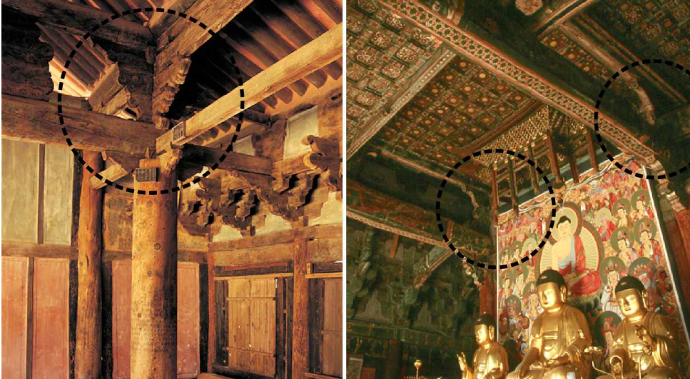
그림 4-3. 차두주에 적용된 적층식 동자주 사례 (좌: 화암사 우화루, 우: 관룡사 대웅전) (출처: 국가문화유산포털)
