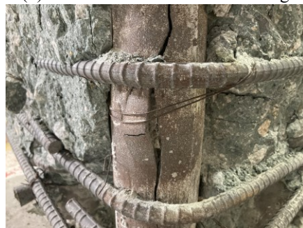
(d) Sleeve rupture & grout crushing \delta = 8.0\%
